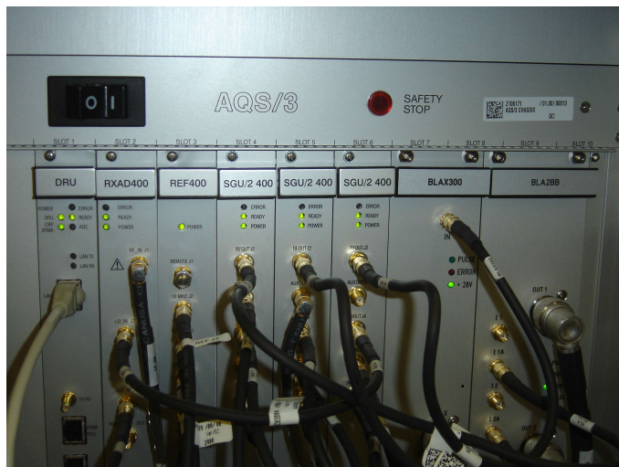
FIG. 1.5 – Câblage de la console
